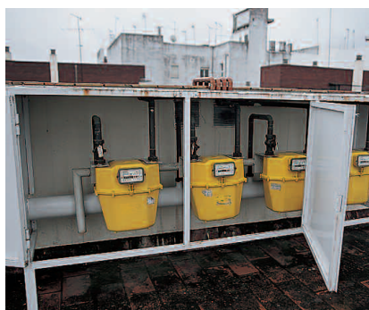
20. BATERÍA DE CONTADORES Y LLAVES DE CORTE.
