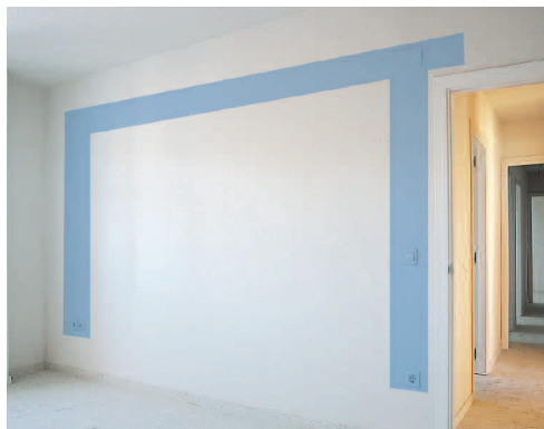
24. Bandas por donde discurren las instalaciones. Salón.
