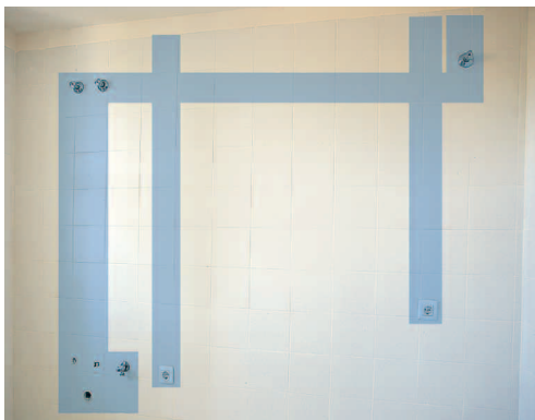
23. Bandas por donde discurren las instalaciones. Cocina.
